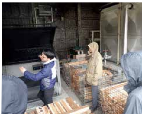
木の駅のボイラー施設
